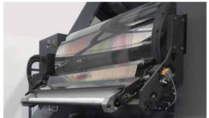
Installation eines FilmCylinderCleaners in einer Folienextrusionsanlage
